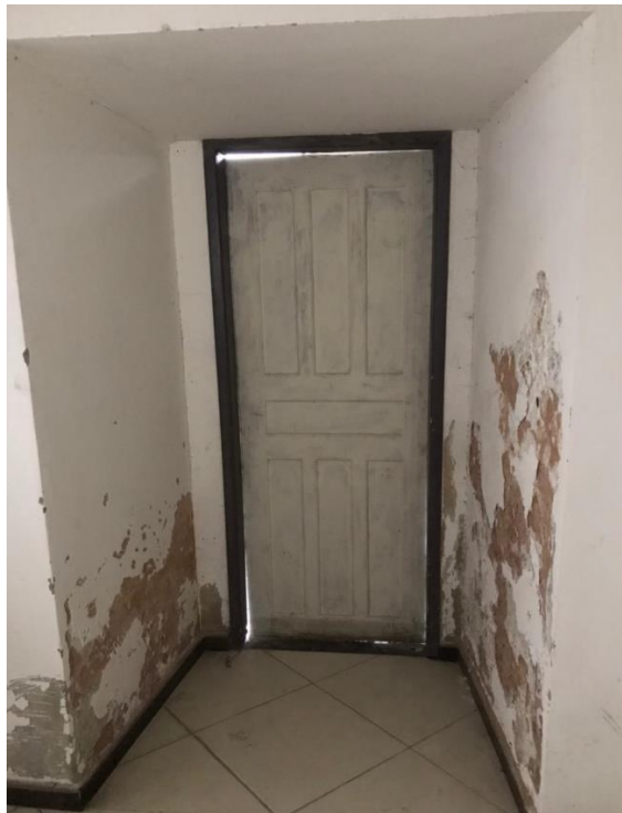
Foto 08: Hall de entrada. Detalhe estado de conservação
