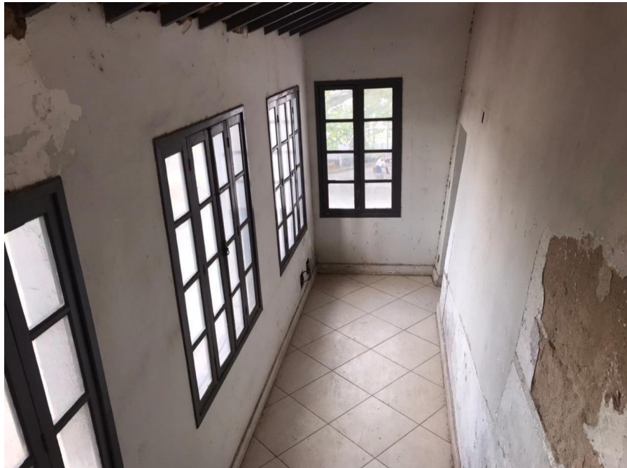
Foto 18: Hall. Detalhe estado de conservação
