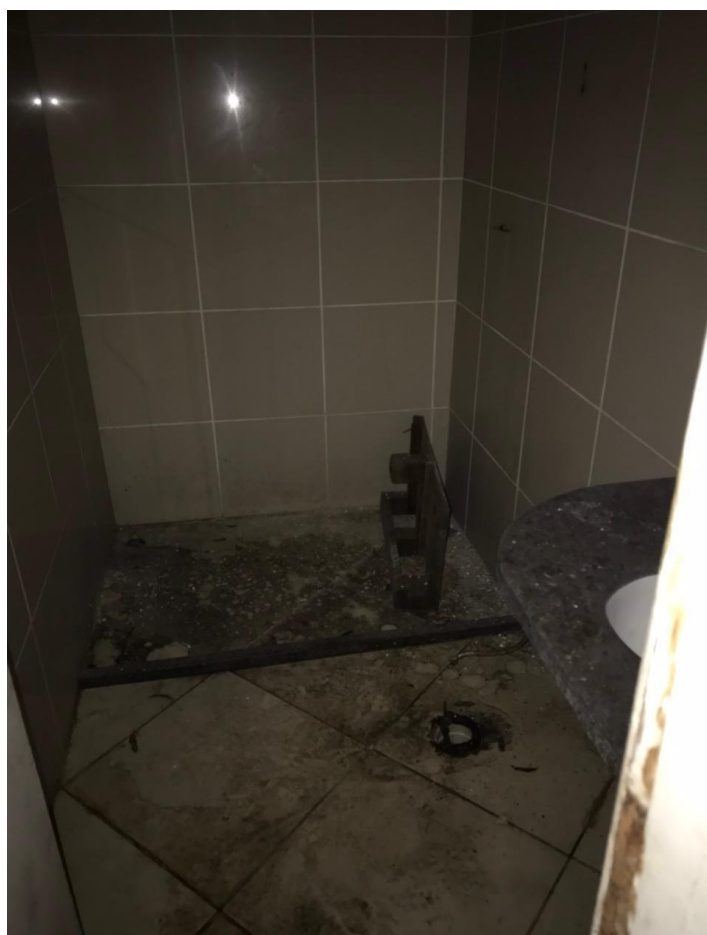
Foto 10: Banheiro, detalhe estado de conservação
